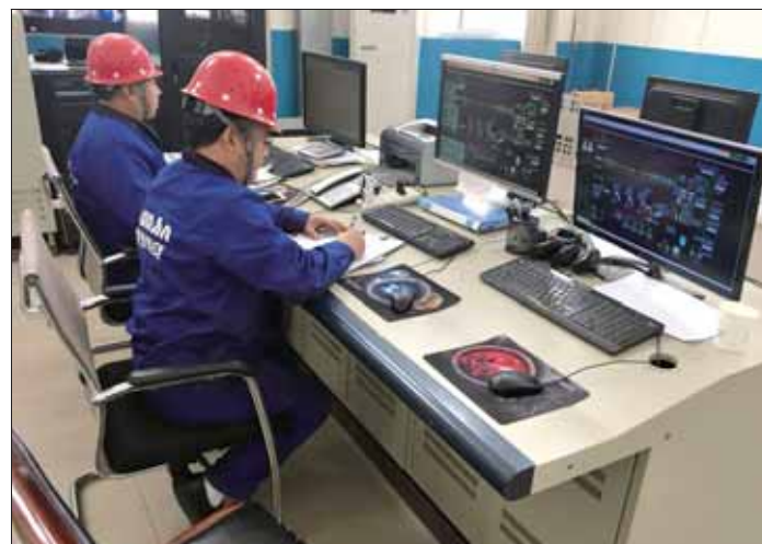
位于同力电厂的鹤壁盾安供热有限公司调度中心24小时监控集中供热管网出水温度，通过调度保证老城区集中供热效果。
