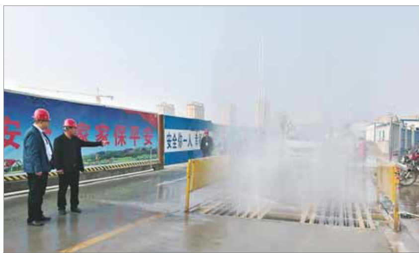
市控尘办督查人员在淇滨区名都东方住宅小区项目施工现场检查车辆冲洗情况。
