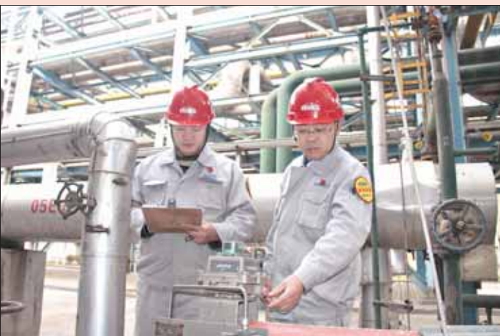
河南能源鹤壁煤化工公司安全巡查人员对甲醇装置进行安全隐患排查。 本报记者 范鑫 摄
