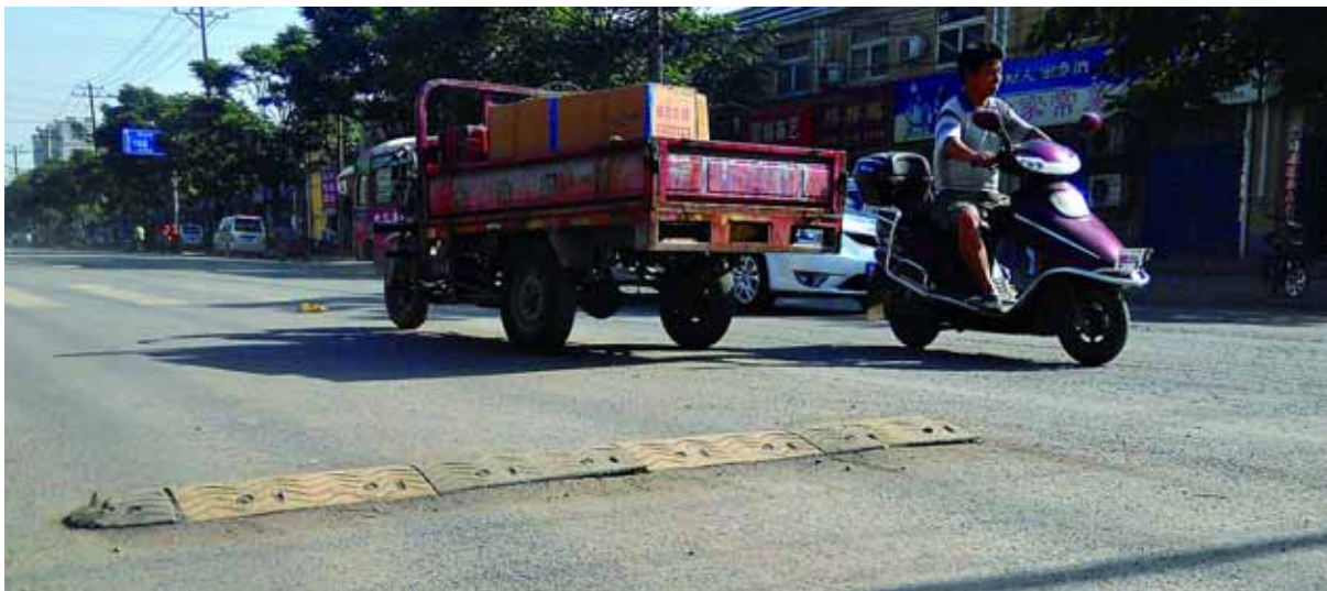
长风路南段山城区实验中学门前的减速带受损严重。
