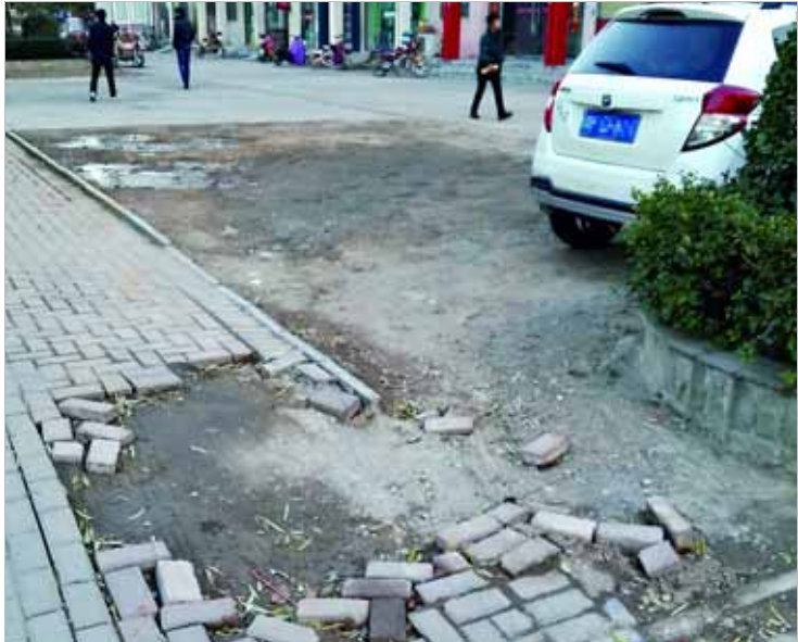
小区北门附近的人行道地砖残缺不全。 百姓热线记者 李凯 摄
