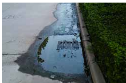
下水道窨井冒污水 百姓热线记者 李凯 摄
