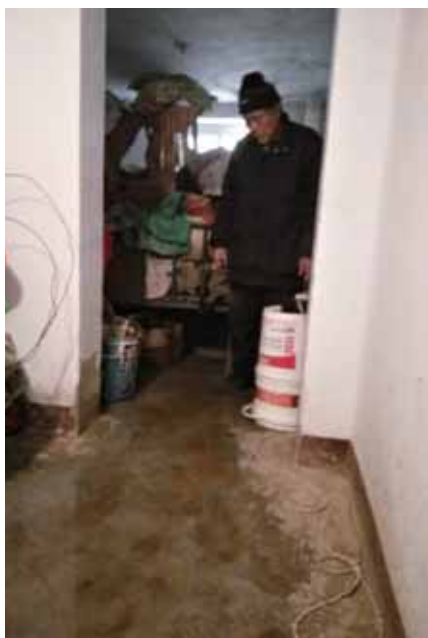
地下室的地面上出现了积水 百姓热线记者 常凯 摄
