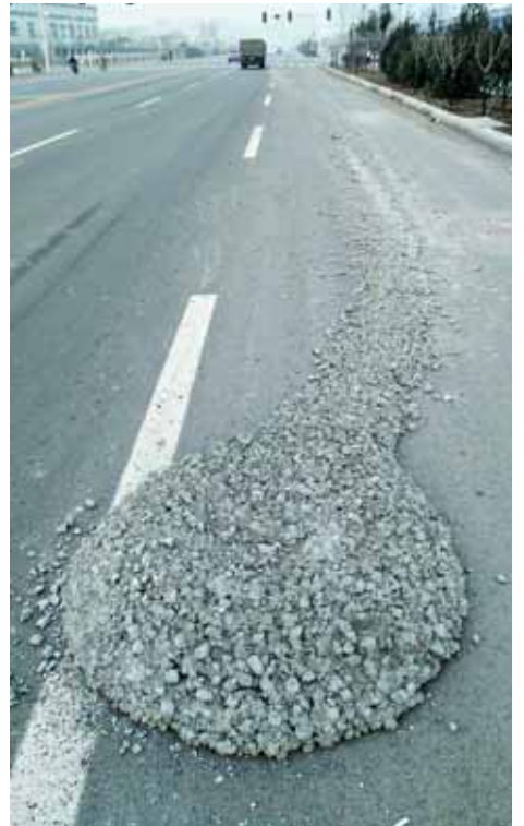
12月28日,市城乡一体化示范区泰山路,记者看到机动车道上留下一大坨混凝土,影响了车辆通行。 晨报记者 张志嵩 摄
