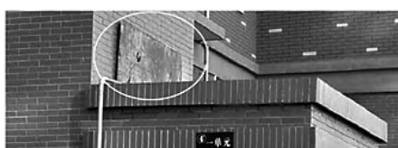
居民用木板(圈内)遮挡居民楼楼道间窗户
