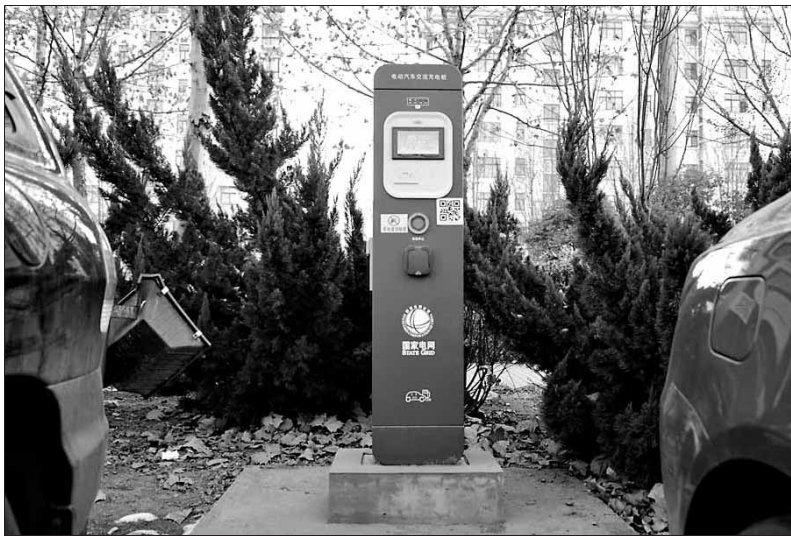
淇滨区黄河路与泰山路交叉口的充电桩
