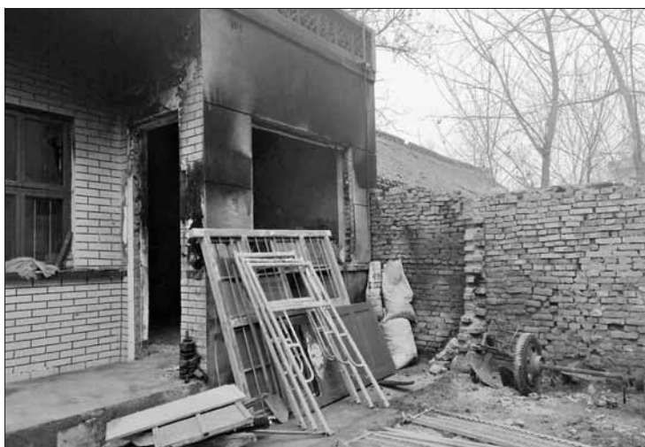
村民家被火烧过的房屋 晨报记者 李丹丹 摄
