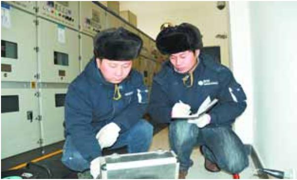
1月9日,浚县供电有限责任公司全面展开对全县变电站设备的维护预试工作。 周峰 摄
