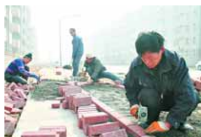
3月10日,泗滨街西段,工人在铺设人行道砖。据悉,泗滨街人行道铺设工程造价总计102万元,预计3月15日完工。 王欢 秦志飞 摄
