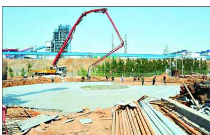
宝山循环经济产业集聚区污水处理厂项目,建设规模为日处理污水9万吨,总投资2.5亿元。该厂在建的生物反应池池底的混凝土浇筑已经完成,钢筋绑扎也完成了75%(摄于4月25日)。
