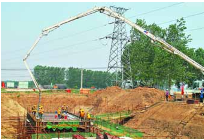
为了保持公路完整,工人们在预制箱涵,为顶涵工程做铺垫。
