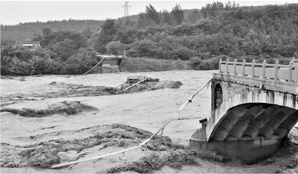
7月9日在四川绵阳江油市拍摄的老青莲大桥垮塌事故现场。
