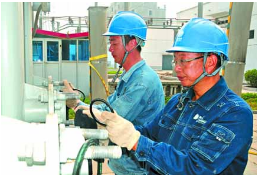
7月8日,浚县供电有限责任公司的工作人员顶着烈日巡查,以确保电网安全可靠运行。 周峰 摄
