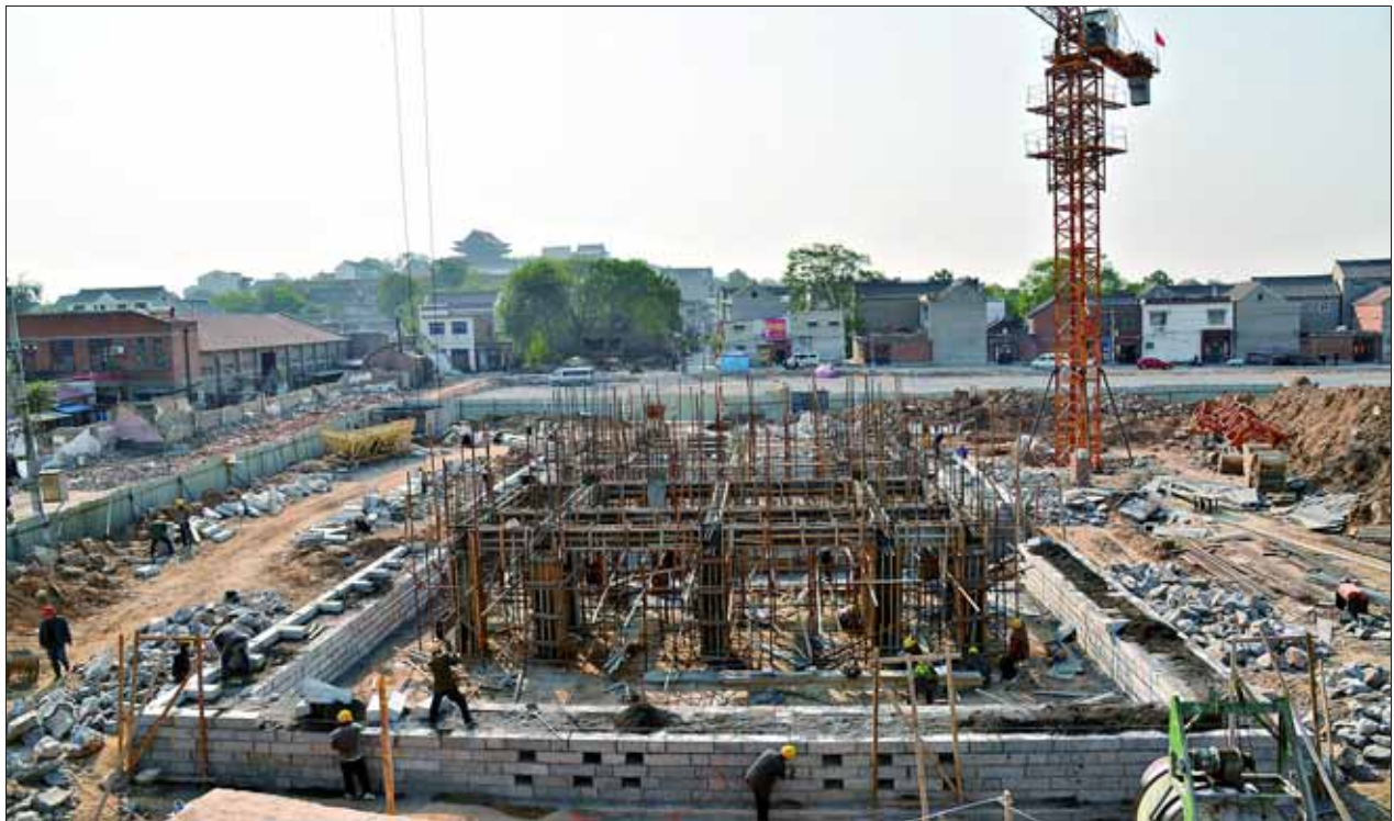
浚县古城西门复建项目目前进展顺利。图为日前工人们正在砌筑条石和安装基础顶至-6米框架柱、梁模板。 浚县古城西门位于西大街西端、云溪桥东侧,门上建有两层高楼,名曰“长清”,城门横额上砖雕“西瞻行翠”。承台长31.64米,宽21.61米,高9.3米;城门楼为重檐歇山顶,三间带圆廊共五间,长20米,宽14米,高12.4米;总高21.7米;城门洞宽5米,高6.18米。 尚海民 摄
