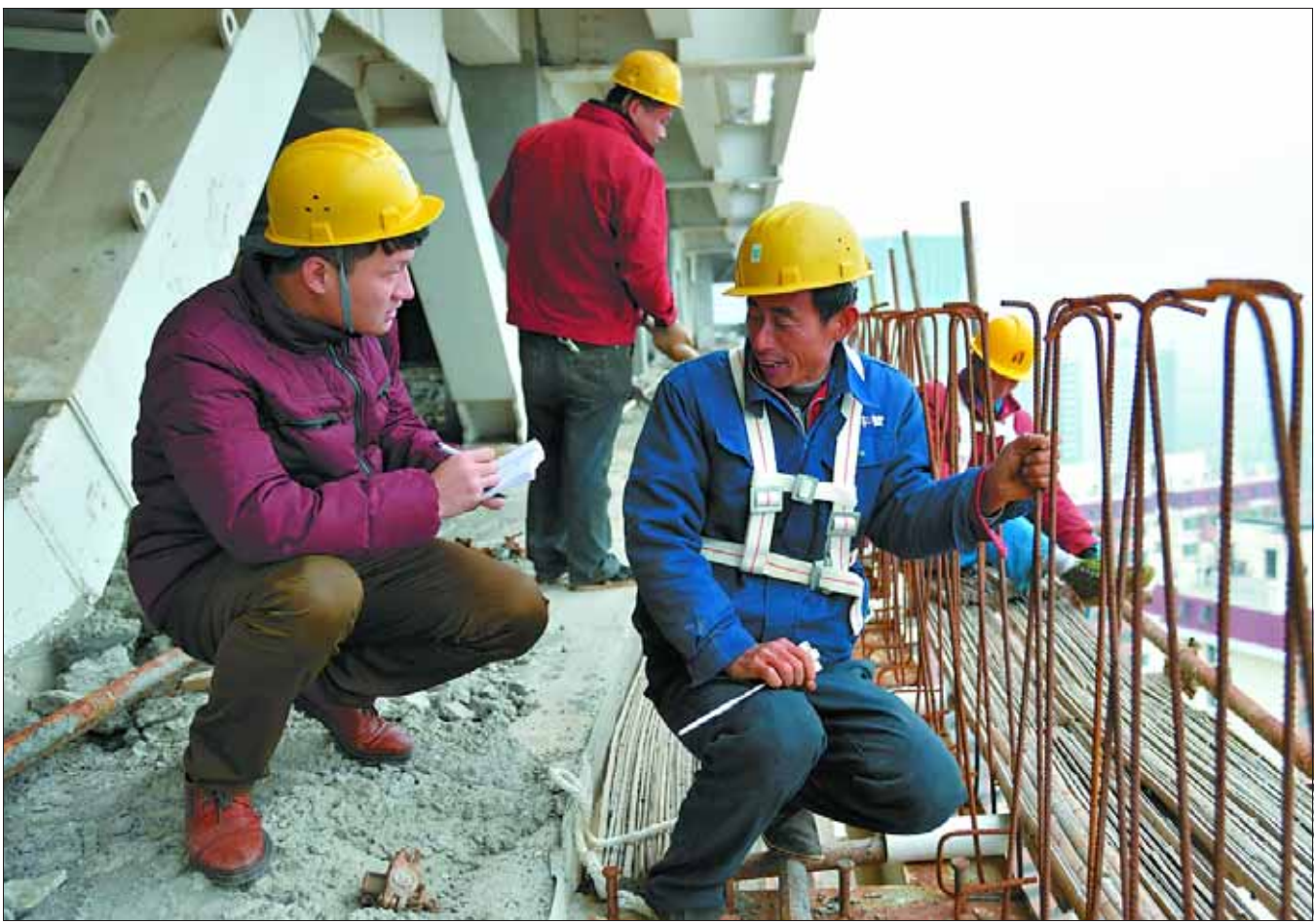
11月8日，鹤壁日报见习记者张晓龙（左）在淇水湾商务区龙门大厦22层，采访正在搭建脚手架的工人。本报记者 李国庆 摄
