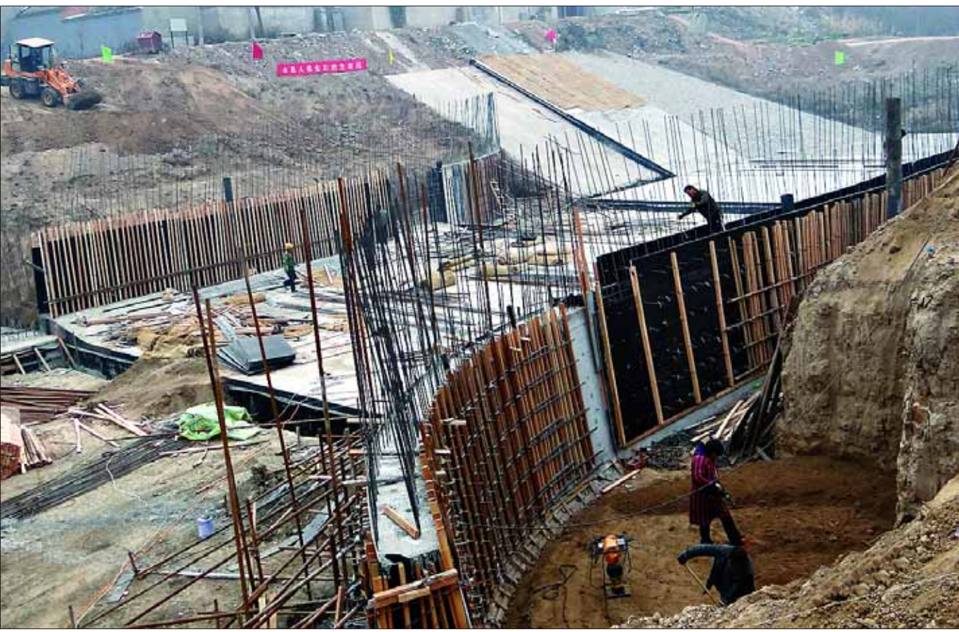
12月3日,浚县卫河橡胶坝工程正在紧张施工。浚县卫河橡胶坝位于浚县老城区以西,项目总投资750万元,坝高4.5米,长22米,可拦蓄水210万立方米。目前,已开挖土方1.2万方。项目建成后,将成为海河流域一级干流上的第一座橡胶坝。 本报记者 袁国强 摄
