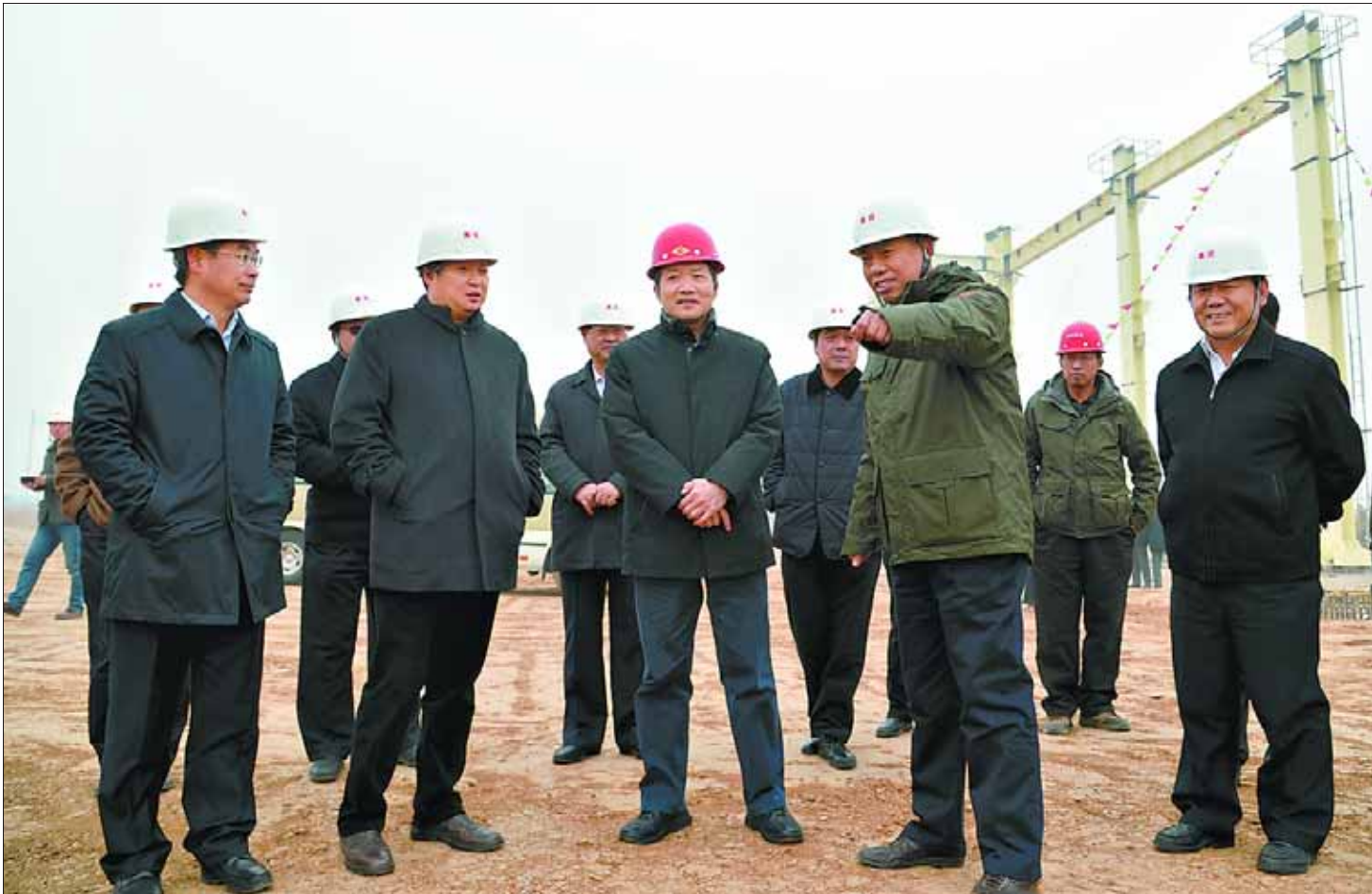
1月10日,市委书记魏小东(前排左三)在鹤淇电厂项目建设工地调研。
