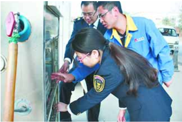
近日，市质监局山城分局对辖区内的压缩天然气加气站开展了专项计量监督检查。目前，辖区内的加气机已全部改为以质量显示加气量。图为执法人员正在检查某加气站加气机的电子控制器等接口处的铅封是否完整。
