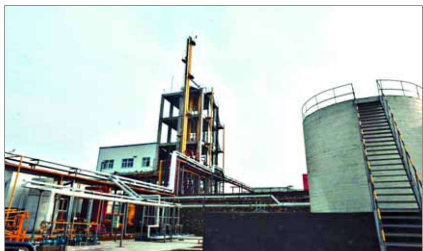
赛科化工项目二期设备已安装完毕
