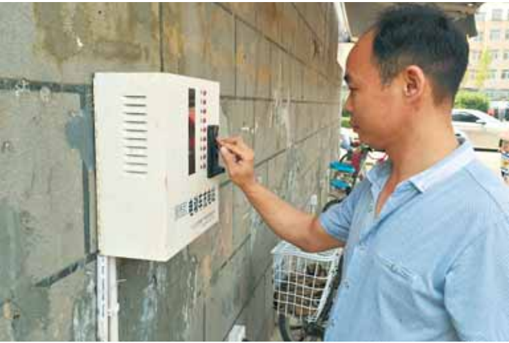
图为社区居民正在社区电动车充电站前投币，为电动车充电。
