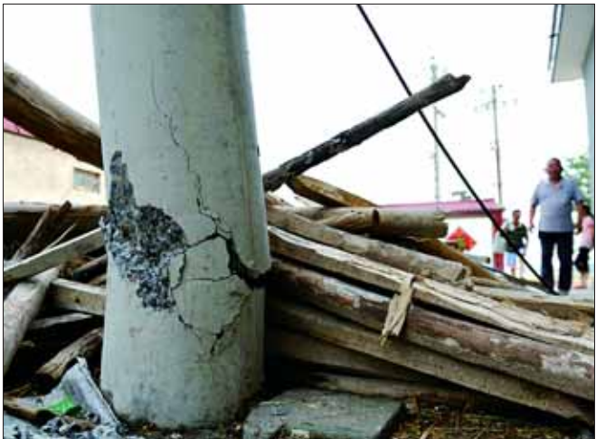
淇县西岗镇大车村3根电线杆断裂，导致停电。 淇河晨报记者 张志嵩 摄
