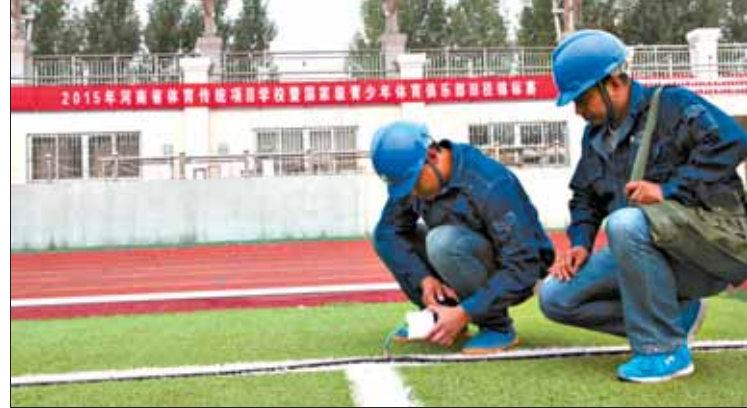
7月25日早晨7时左右,淇县供电公司朝歌供电所的工作人员在淇县一中比赛场地上检查电插板的安全性。
