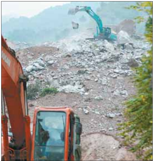
8月12日,抢险人员在山体滑坡事故现场清理土石方。 新华社记者 李一博 摄
