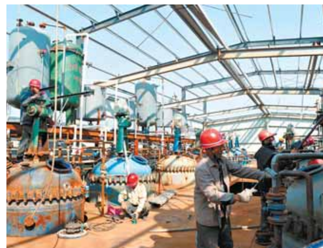
禾源生物科技有限公司年产3000吨二甲基硫代磷酸胺项目主体设备近日已安装到位,因为工程人员正在给设备刷防锈漆。 张静轩 摄
