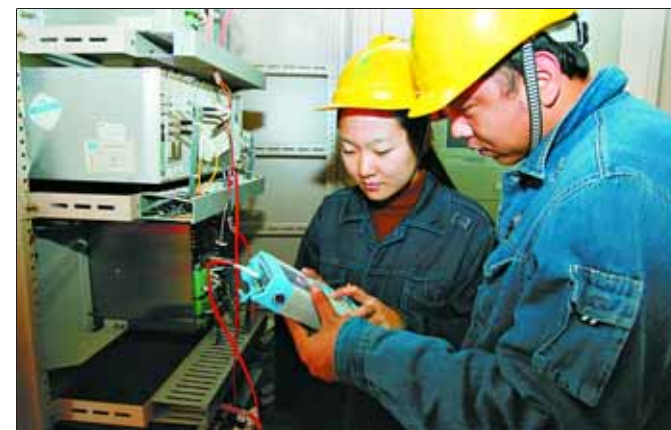
11月4日,鹤壁供电公司工作人员对淇县220千伏变电站的数字化终端机进行数据检测。
