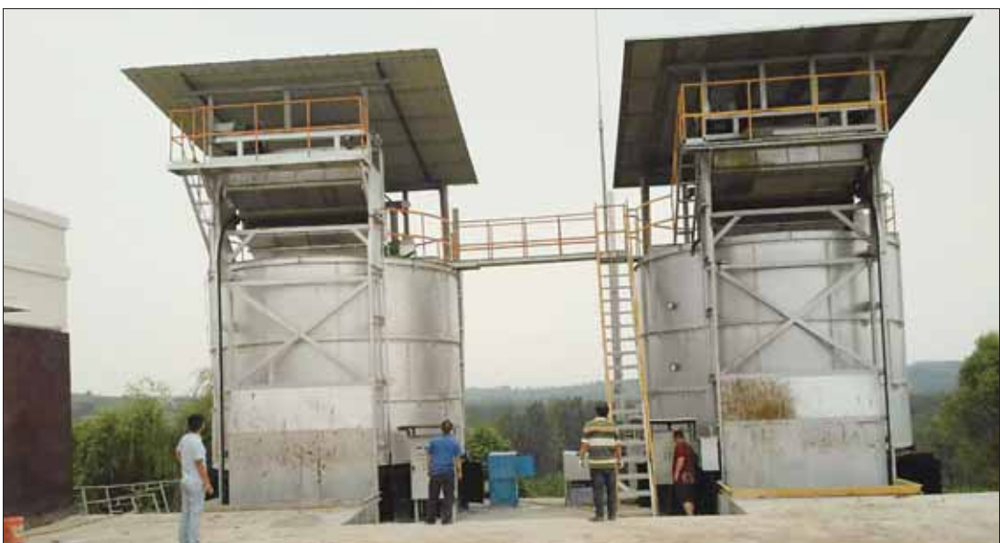
8月8日，鹤壁东海生物科技有限公司工作人员在对柳江鸡场罐式有机物好氧发酵机进行设备检测和维护。 本报记者 渠稳 摄
