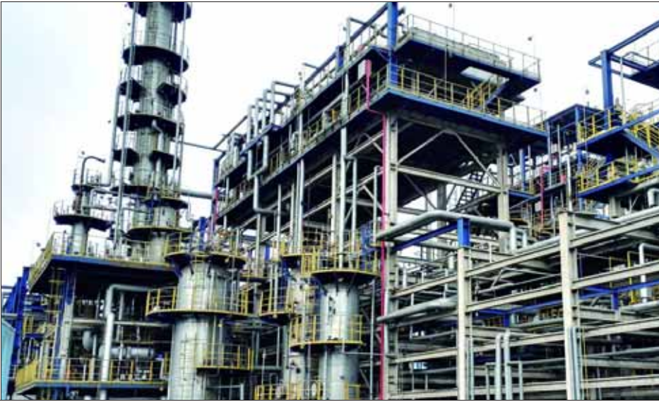
鹤壁华石联合能源科技有限公司年加工15.8万吨煤焦油综合利用项目超级悬浮床工业示范装置，是国内首套自主研发的装置，关键核心技术处在世界领先水平。
