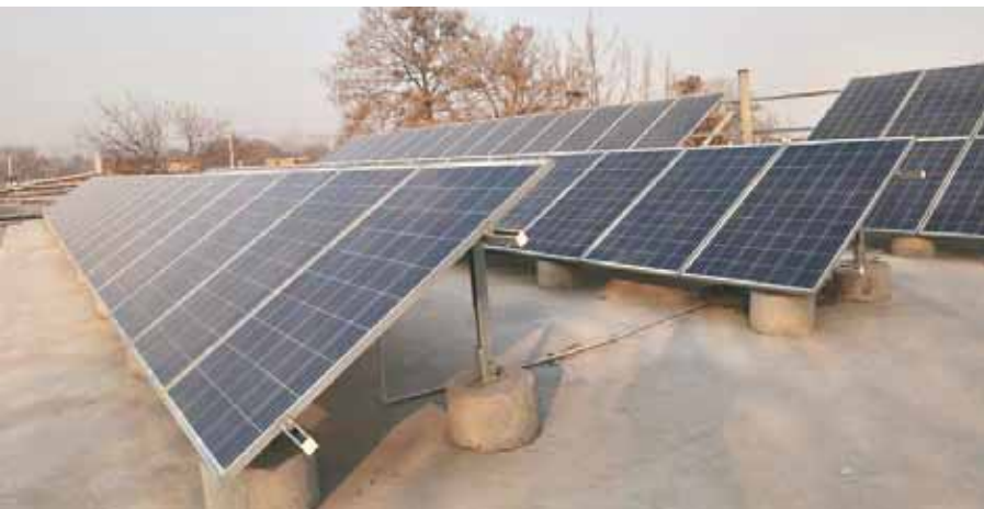
村民的屋顶分布式光伏电站。
