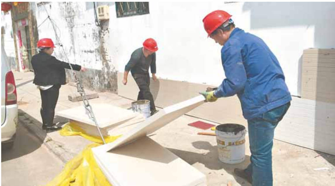
对农村建筑进行能效提升改造是我市农村冬季清洁取暖试点工作的主要技术路径。图为施工人员对农房外墙粘贴具有保温性能的挤塑聚苯板。
