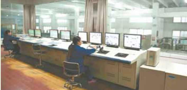
飞天农业开发股份有限公司控制室
