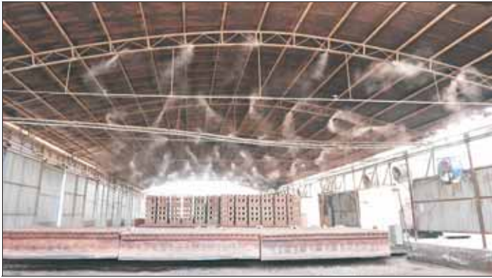
浚县黎新新型节能建材有限公司安装的雾化喷淋设施,每两小时对周边环境进行一次自动喷淋。
