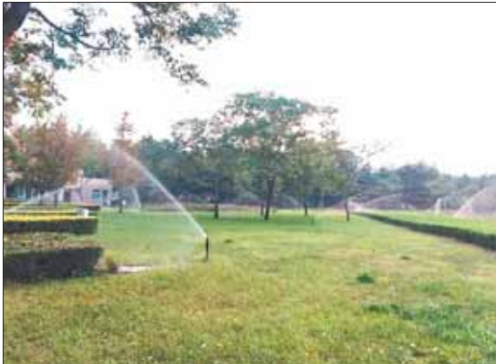
市委市政府合署办公区的节水喷灌系统。
