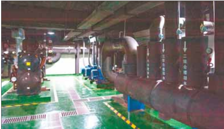
市委市政府合署办公区的中央空调机房。
