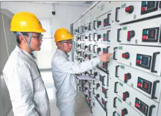
市委市政府合署办公区的弱电控制室。
