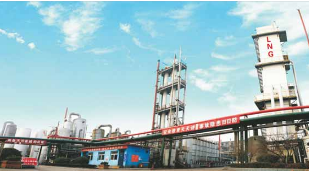
宝发公司投资8000余万元新增一套年产8000吨LNG（液化天然气）设备，该设备主要是将废气中的甲烷进行回收，送冷箱制成LNG。
