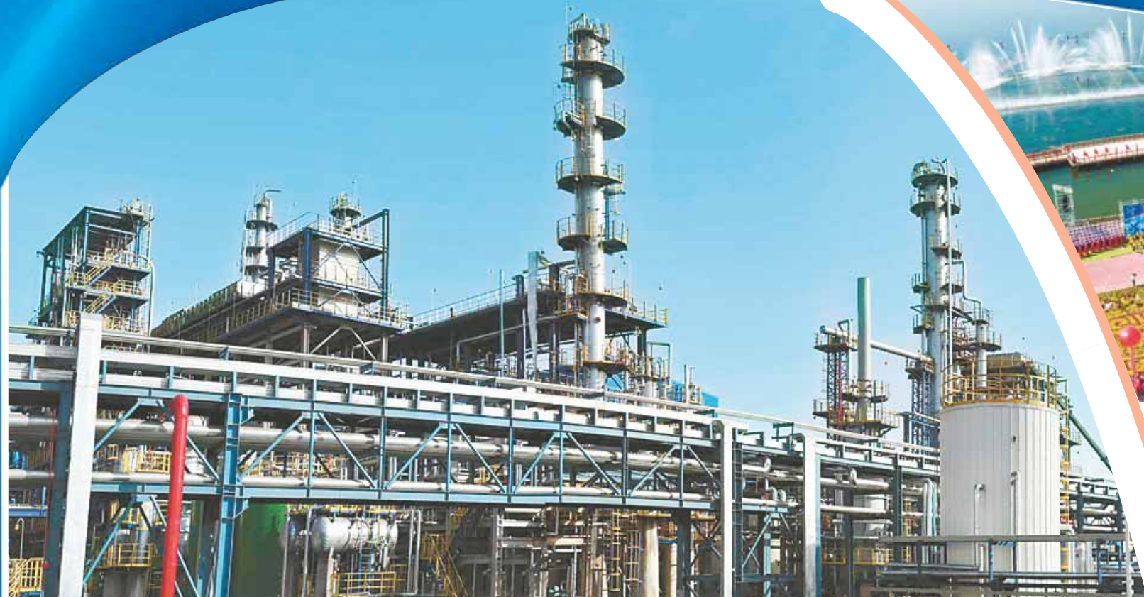
北京三聚环保新材料股份有限公司与北京华石联合能源科技发展公司自主研发的MCT悬浮床加氢成套工业技术，为解决重油加工的世界性难题提供了全套解决方案。图为位于鹤壁市山城区的鹤壁华石联合能源科技有限公司年产15.8万吨煤焦油综合利用示范项目生产设施。
