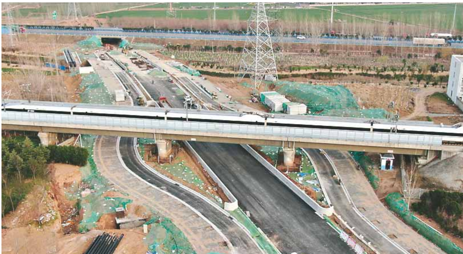
柳江路下穿高铁高速项目:施工单位正在铺设全线路灯穿线管和浇筑路灯基座。
