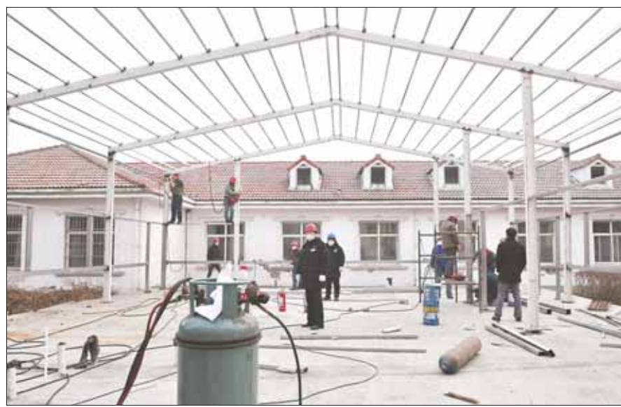
建设负压病房,宁可建而不用,绝不用而无备。从大年三十上午接到任务到大年初八负压病房主体完工,再到交付使用,市住建局的同志们带领建设者通宵达旦奋战在施工现场。图为1月29日,市第三人民医院负压病房正在加紧施工。
