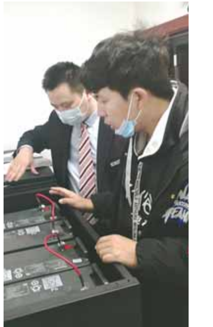
中行鹤壁分行工作人员正在进行营业网点电源设备巡检。 张克忠 摄
