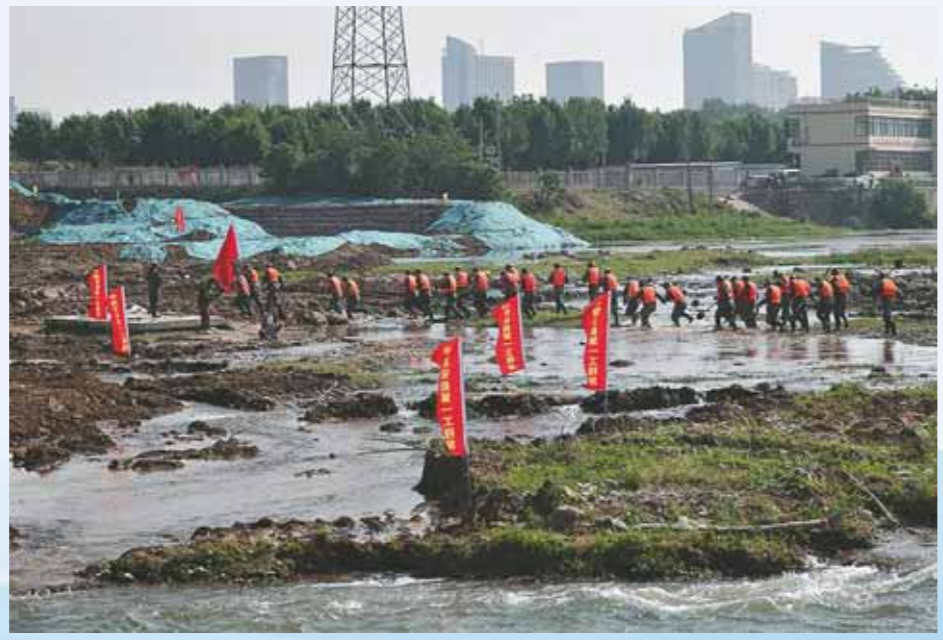
针对巡查发现的管涌险情,淇县民兵分队等抢险力量快速抢险处置。
