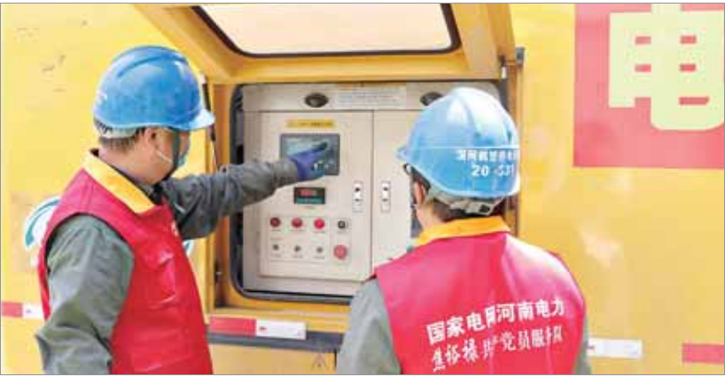
国网鹤壁供电公司工作人员正在调试应急发电车。 孙颖 摄
