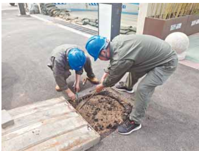
国网鹤壁供电公司工作人员在华山路开闭所开展防汛隐患排查特巡。
