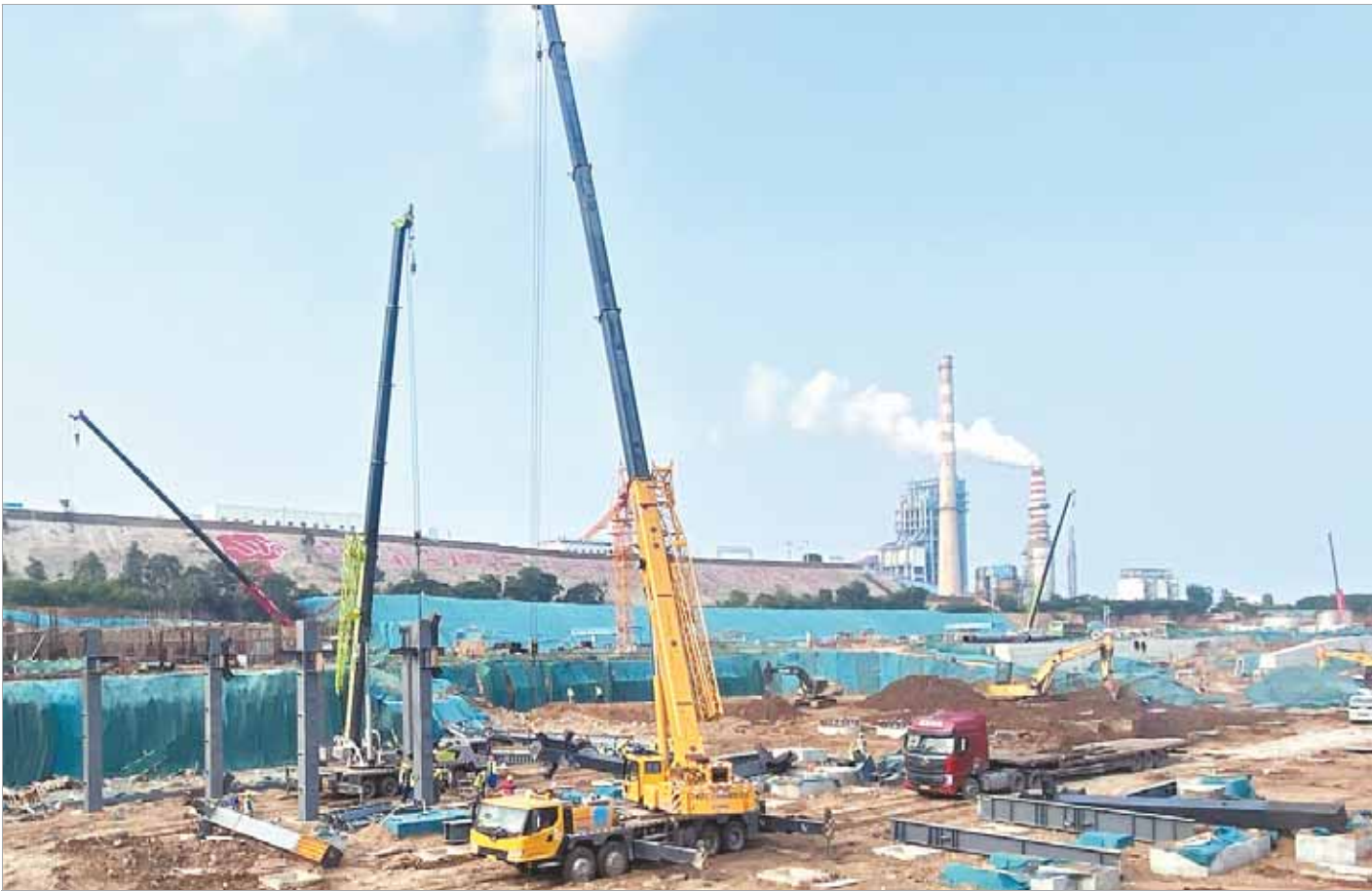
由市政府与河南能源化工集团合作建设的鹤壁龙宇新材料有限公司年产30万吨聚甲醛一期项目,投产后将成为全国最大的聚甲醛生产基地。
