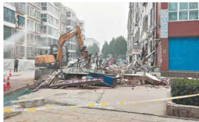
为推进淇滨区黎阳路街道老旧小区改造工程,11月8日,该街道综合执法局联合颍秀园社区,加大违章建筑拆除工作力度。截至目前,拟改造小区内私搭乱建、违章建筑已全部拆除完毕。图为违章建筑拆除现场。 本报记者 原昆鹏 摄
