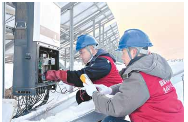
12月19日,鹤壁鹤源电力(集团)有限公司综合能源分公司运维人员冒着严寒到鹤山区龙宫村光伏扶贫项目龙宫光伏电站检查维护设备,确保极寒天气下光伏电站稳定运行。此前,他们还还对站内光伏面进行了除雪作业。王柳 摄
